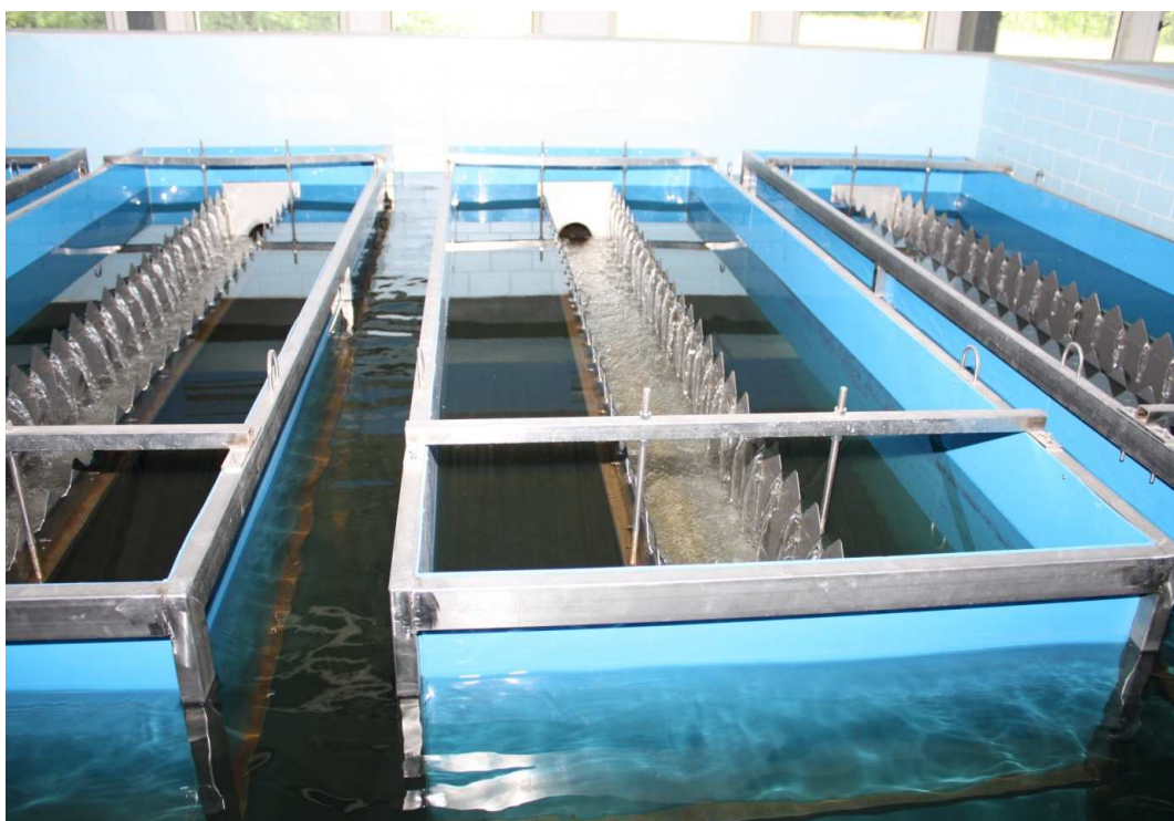
Obr.1 Použitá korozi-vzdorná ocel v úprav-ně vody
