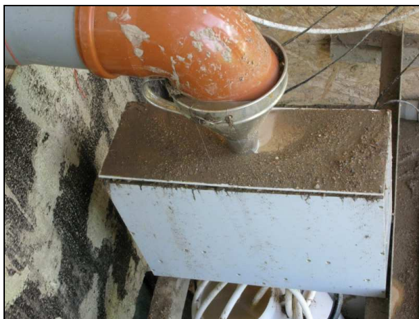
Obr.3 Po extrémně intenzivní srážce došlo k ucpání klapátek
